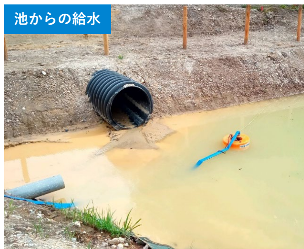
噴射ポンプ槽からの排水
